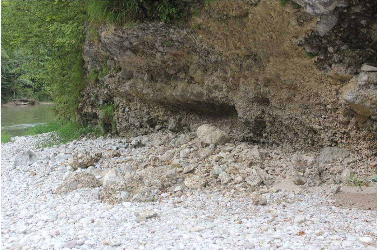
Abb. 9.: Konglomeratwand, beginnende Erosion. Einzelne Sedimentbrocken lösen sich aus der Wand.
