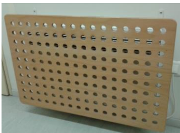
Beispiel für eine Heizkörperverkleidung
