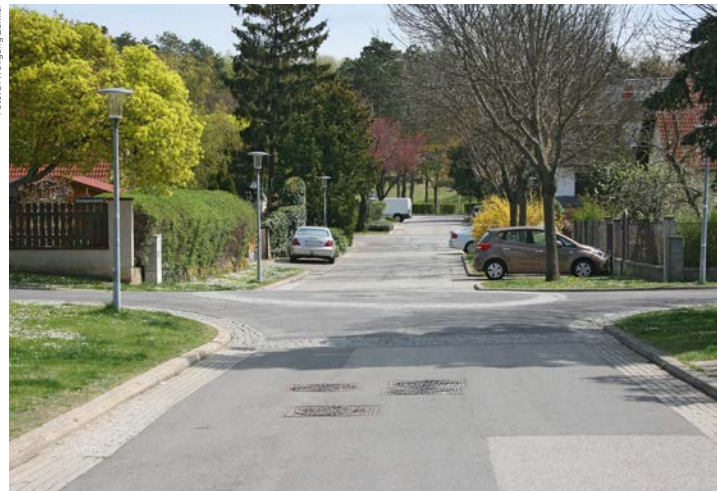
Gemeinde Schwechat, Fahrbahnversatz, Fahrbahnanhebung im Kreuzungsbereich
