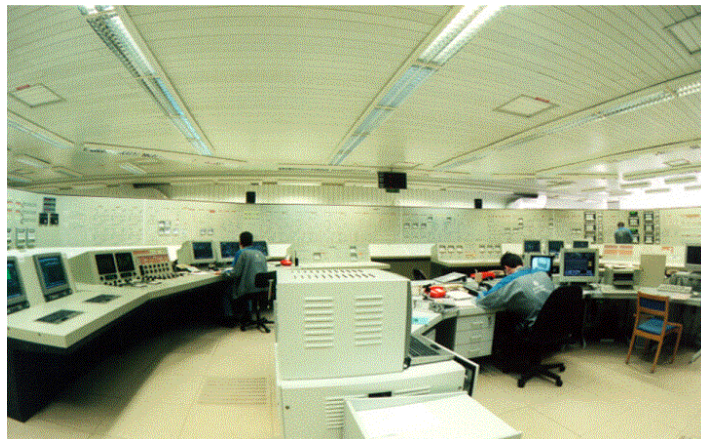
Abbildung 16: Derzeitige Kontrollraum-Version von Mochovce 1&2 21
