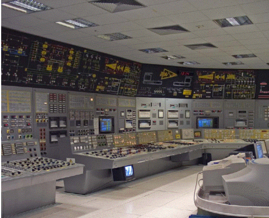
Abbildung 13: Kontrollraum eines WWER 440/213 (Bohunice V2). 17
