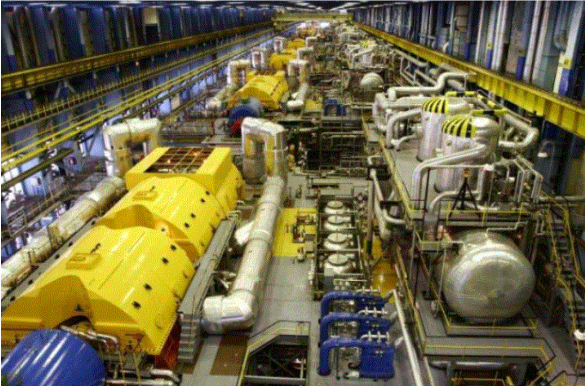
Abbildung 11: Blick in die Turbinenhalle. 15 Die acht Turbinen, zwei pro Reaktor, sind in Mochovce in Achsenrichtung aufgereiht.
