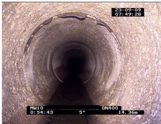
Betonkanal, Alter > 40 Jahre, Dichtheit fraglich, wenige optische Mängel – kein unmittelbarer Handlungsbedarf
