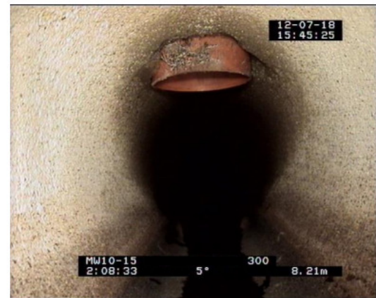
Betonkanal, Alter > 40 Jahre, einragender Anschluss Rohrscheitel – kein unmittelbarer Handlungsbedarf
